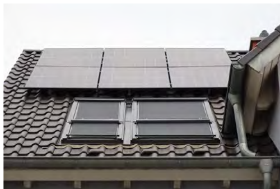
Eines von vielen Viernheimer Hausdächern mit einer Fotovoltaikanlage. © Stadt Viernheim
